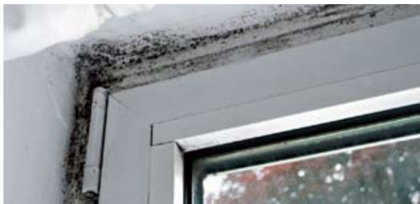
Skimmelvækst omkring et vindue.
