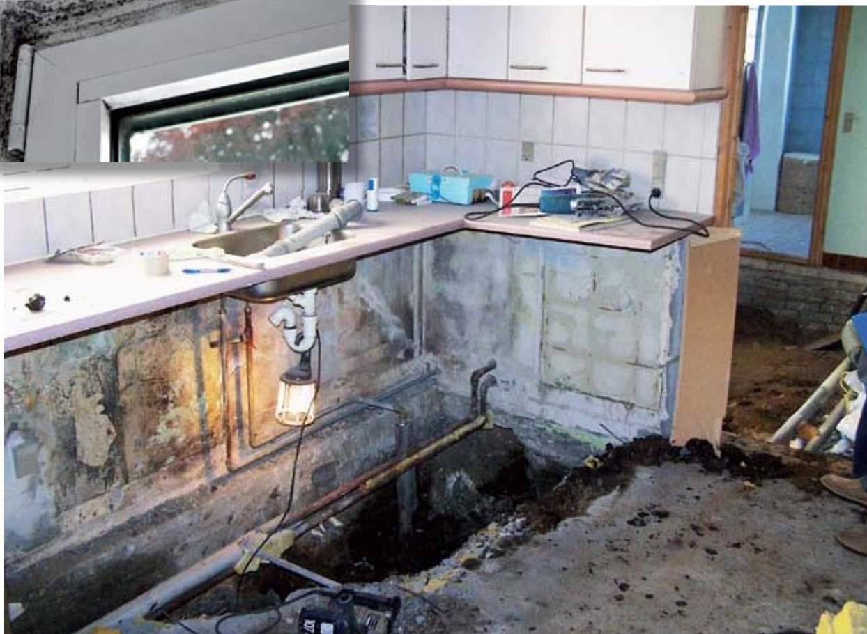
En rørskade har ledt til skimmelvækst under gulv og bag køkkenskabe.
